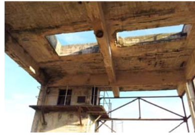
Corrosión de armado inferior de losas (planta de cubierta)
