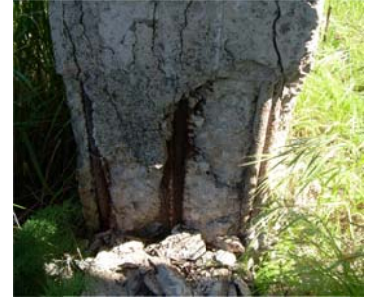
Corrosión de armado de pilares
