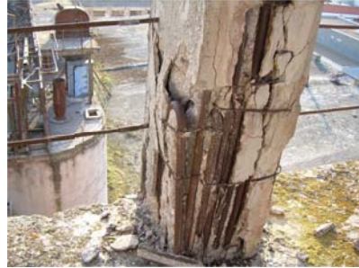
Corrosión de armado de pilares
