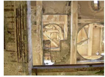
Corrosión de armadura de vigas
