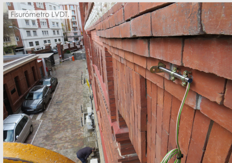
Conexión de instrumentación a PC industrial.
