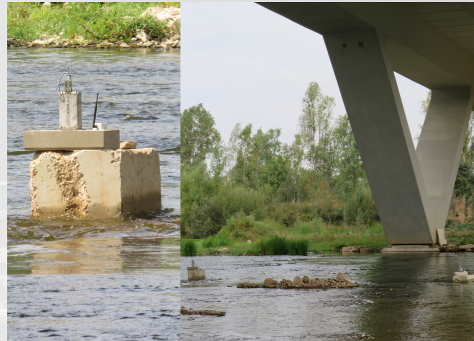
Sensores bajo vigas en zona de río
