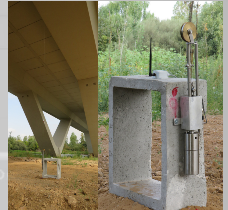
Sensores bajo vigas
